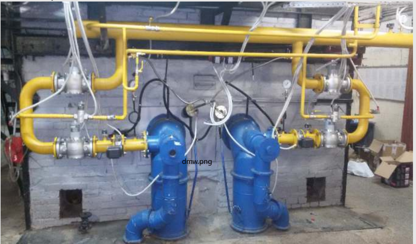
Модернизированная газовая рампа и автоматика котла ДКВР-6,5
